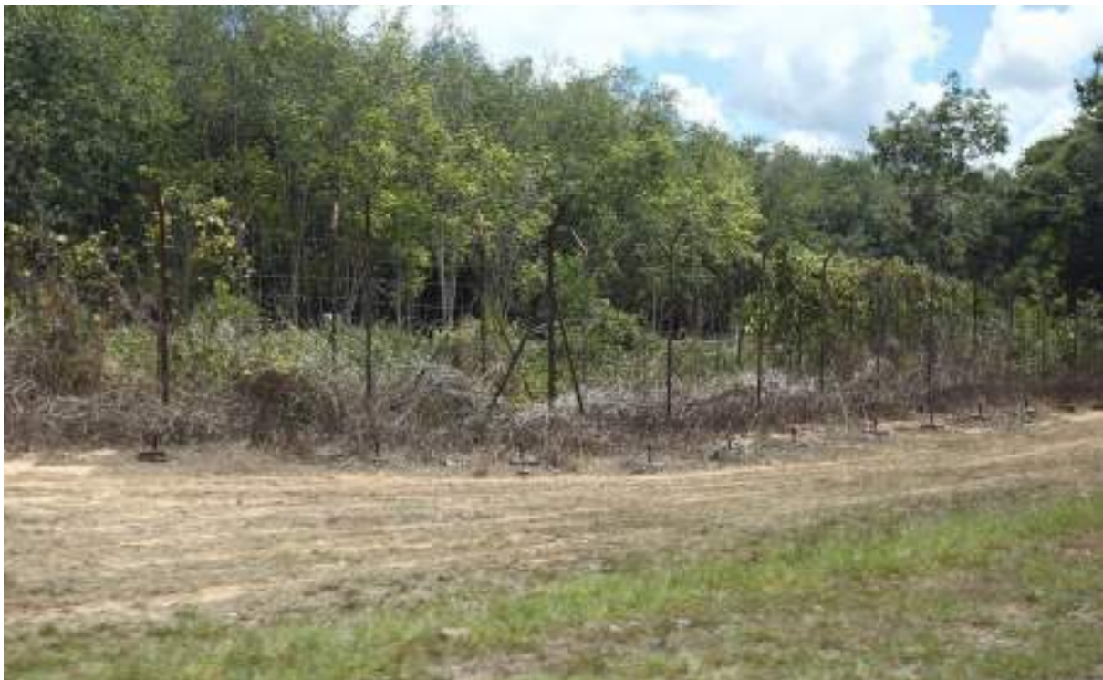
Gambar 54 : Pagar keselamatan dua lapisan yang uzur di sepanjang sempadan jalan KESBAN sempadan Malaysia – Thailand.
